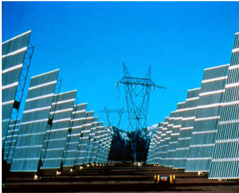
1 MWp, Primera central – California
