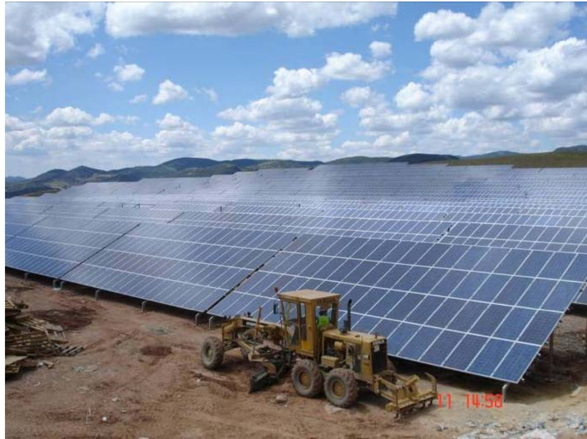
4 MW em Jaén, Espanha
