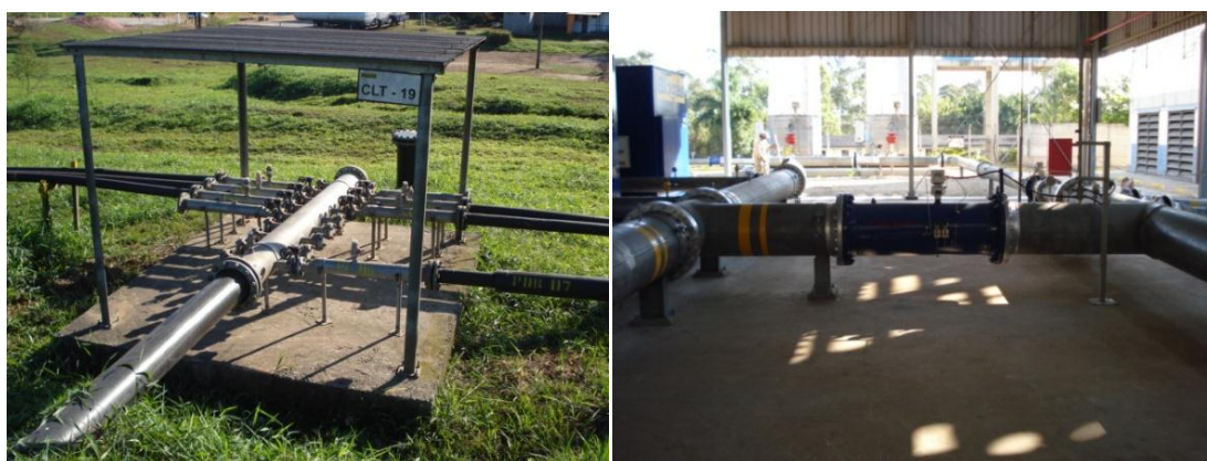
Fotos: sistema de captação do biogás
