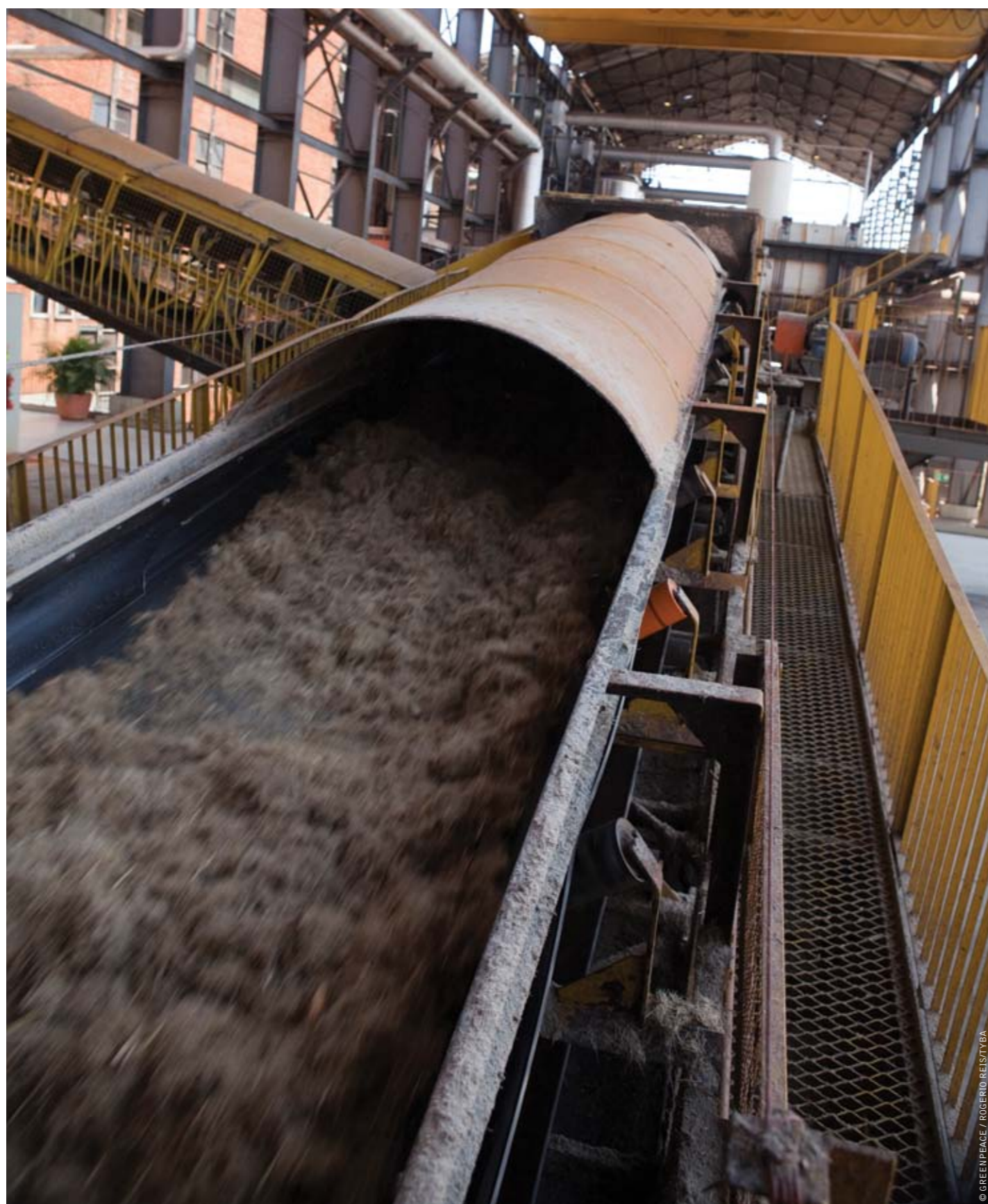
imagem USINA DE COGERAÇÃO QUE UTILIZA CAVACO DE MADEIRA COMO COMBUSTÍVEL EM ITACOATIARA, AMAZONAS
